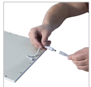
Il collegamento elettrico viene eseguito sul retro dell'apparecchio.
